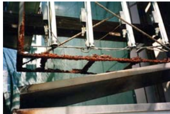
↑看板底部の脱落
